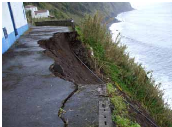
Queda parcial de um troço/trilho de Caminho na Fajã no Araújo
