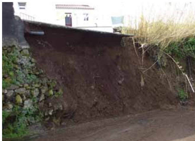
Queda de muro de suporte no Treito da Feteira Pequena
