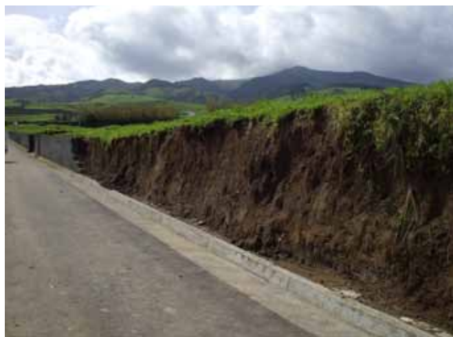
Queda de muro no Caminho de Acesso à Senhora do Pranto
