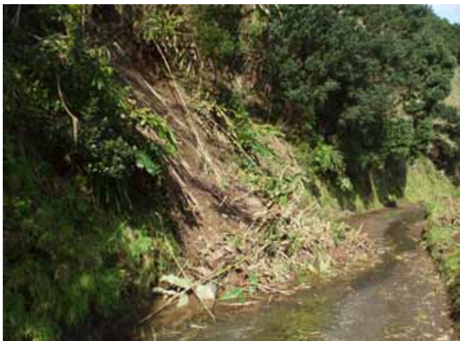
Queda de taludes de dimensão acentuada no Caminho do Calhau, na Salga
