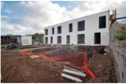
Execução de 3 Moradias de Habitação Social, na Rua Pe. José Pacheco Monte Vila do Nordeste
